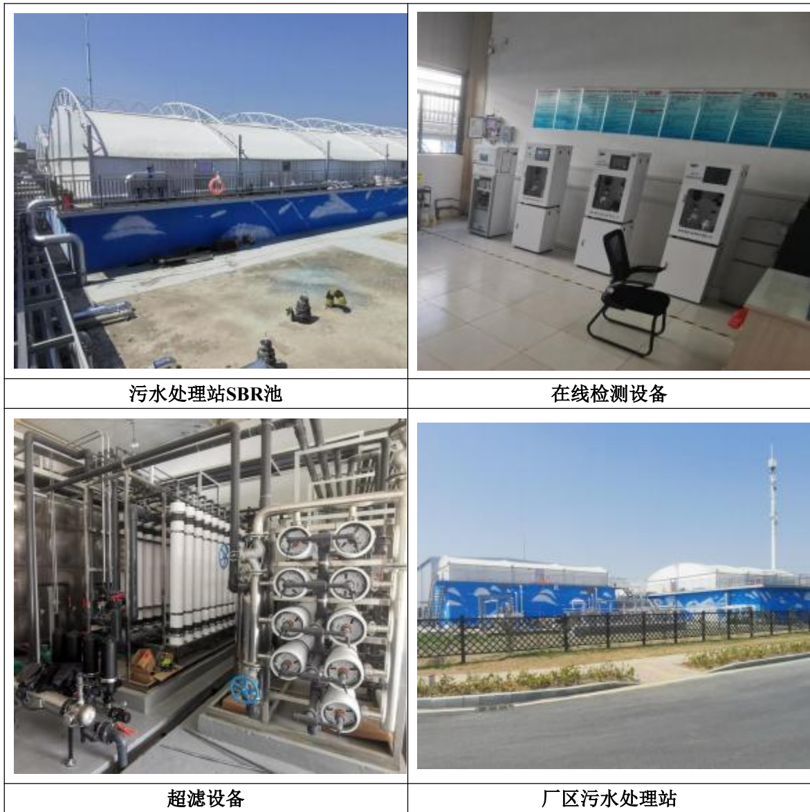
图4.1-2 废水处理措施照片
