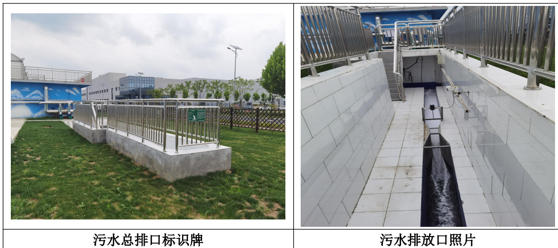
图 4.1-4 废水排放口照片
