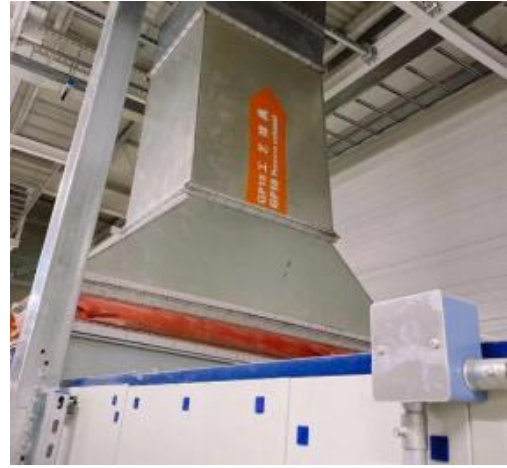
车身车间焊接、打磨排气筒内部
