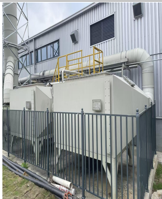
污水处理站二级活性炭
