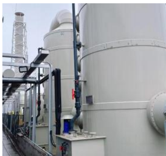
污水处理站废气系统
