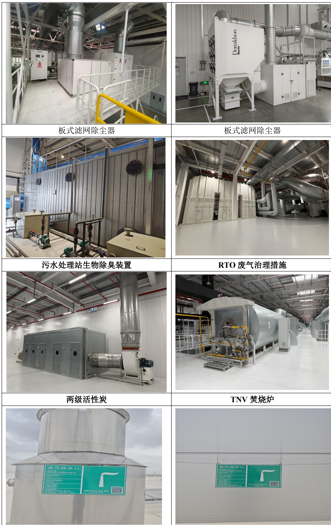
图 4.1-3 废气治理措施照片
