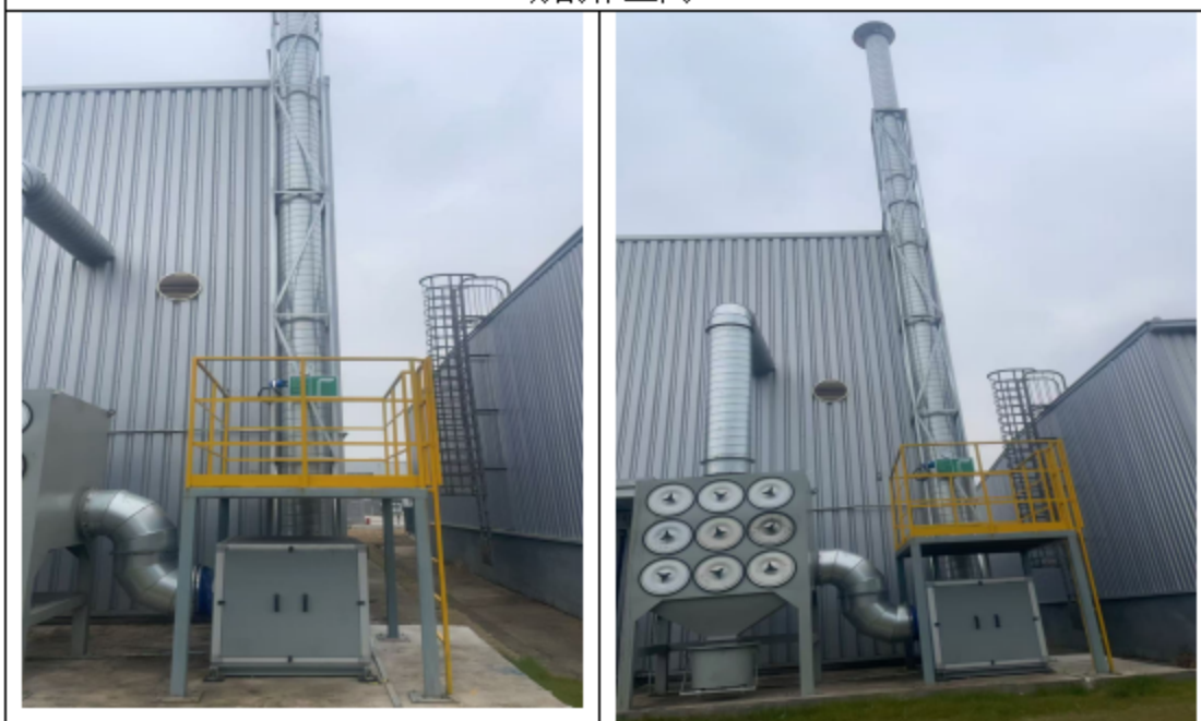
切割废气排放口
